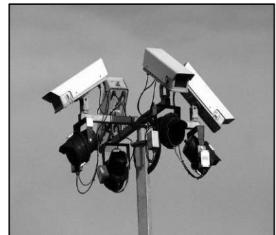
Un moderno impianto di videosorveglianza
